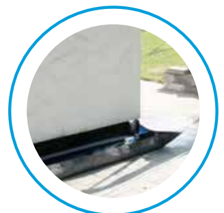
Das Abwasser wird mit Auffangwannen aufgefangen.
